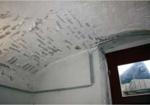
Feuchtigkeitsbelastete Decke im Keller
